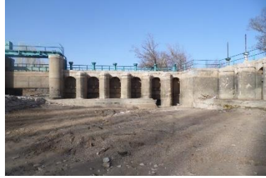
Taşkın Tahliye Kapakları
