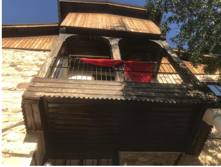
Foto.4- Arapgir Kaşkal Konağı Batı Cephedeki Cumba.
