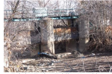
Taksim Taşkın Tahliye Kapakları
